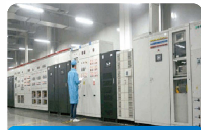
充电车间-回馈式充放电/电池在线检测
